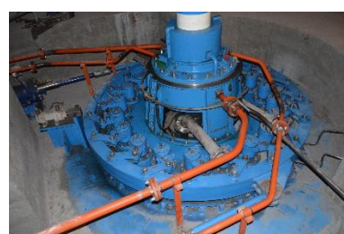
Vedere turbina hidraulică instalată
