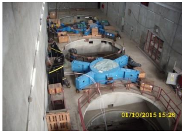
Interior sala mașinilor
